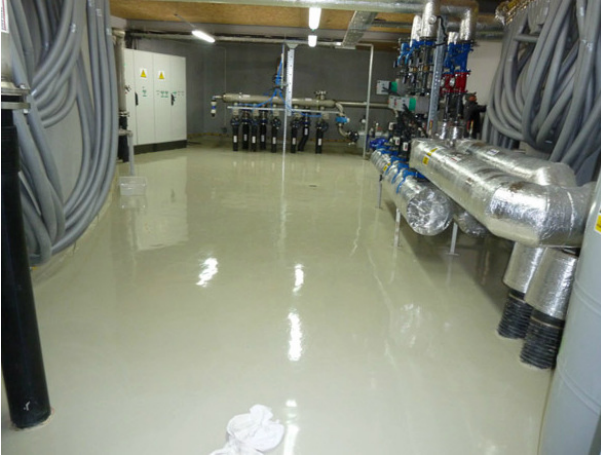
Rys. 111. Pomieszczenie pompowni źródło: www.odrzechowa.izoo.krakow.pl
